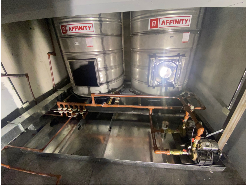
SALA DE TANQUES EN ENTREPISO
